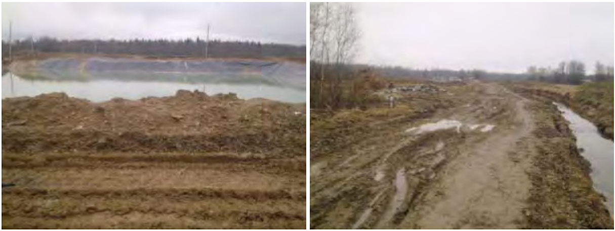
Строительство полигона (захоронения) ТБО около садоводства Пупышево апрель 2010 г. Фото www.pupyshvevo.com/forum на ветке Полигон твердых бытовых отходов (ТБО)
